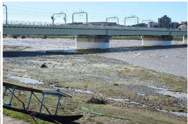
ドッグラン付近の被害状況 (東和泉四丁目 9 番先から小田急多摩川橋梁方向を撮影)
